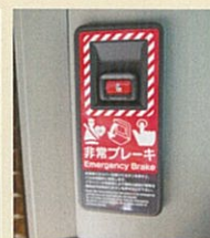
非常ブレーキスイッチ
